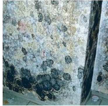
Tipisks nepareizas ģipša plātņu izmantošanas gadījums: auksta pagraba siena tika apšūta ar ģipša plātnēm. Pēc karstā ūdens caurules plūsuma tvaika ietekmē dažās nedēļās parādījās bagātīga, bet indīga sēņu kolekcija. Foto: TTA
